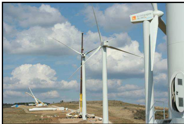
Chantier de l'extension du parc éolien de Roquetaillade : montage d'une éolienne © Abies
